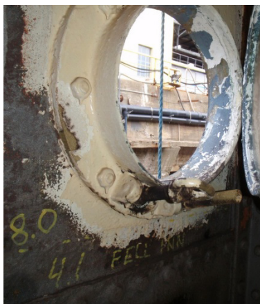
Rusttæring under lysventil på D/S Kysten. Tallene til venstre i bildet angir tykkelsesmål i hudplata etter måling med ultralydapparat. Som vi ser er hudplata i underkant av lysventilen kun halvparten av tykkelsen ellers (Foto: Thomas Olsen 25.10.10)
