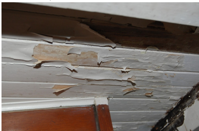
Malingen flusser av på undersiden av et dekk. Malingen slipper ikke nok fuktighet gjennom med det resultat at den løsner.
