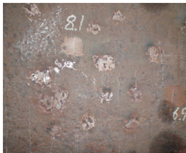
Sveisede groptæringer i hudplate. (foto: BDF.)
