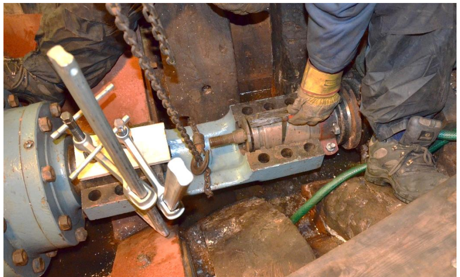
Litt improvisasjon. Her er halve klemflensen montert fast på motorens utgående aksling, og brukt som "rettholdt". Bladsøker brukes til å kartlegge hvor avviket er størst. Utifra målingene danner man seg et bilde av hvordan motoren må flyttes for at akslingene skal bli på linje.
