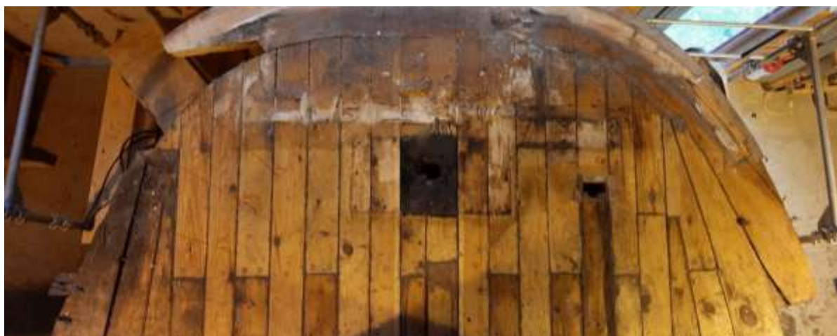
Figur 35. Foto: HFS, 2020. Svært mange plankar er skøyta på same bjelken. Dette er korte plankar som ein ikkje hadde trengt å skøyte i utgangspunktet. Innhaking og støtfordeling på babord side er svært rotete.
