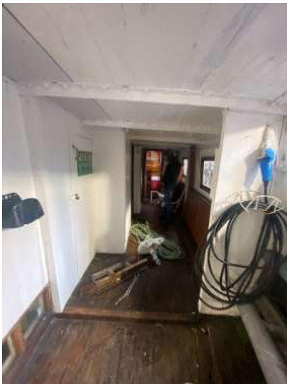
figur 70: Rester av svill i akter skott styrbord, 2021. Skottet ble bygget i 1950.
