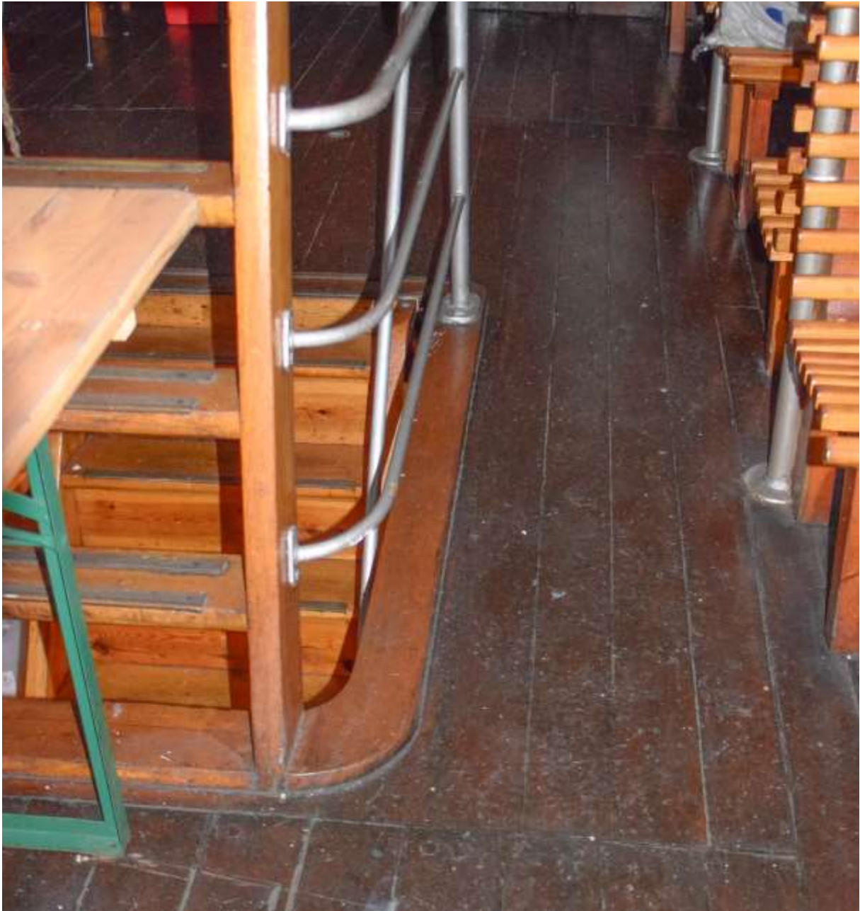
figur 56: Skjøte etter gammel ruff og nedgangskappe i dekk, 2021. Dagens trapp er plassert på samme sted, men retningen er snudd.
