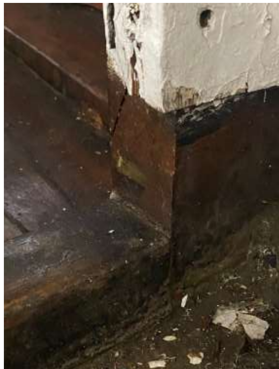
figur 71: Svill, 2021. «Dørstokken» ser ut til å være montert etter at skott er åpnet.
