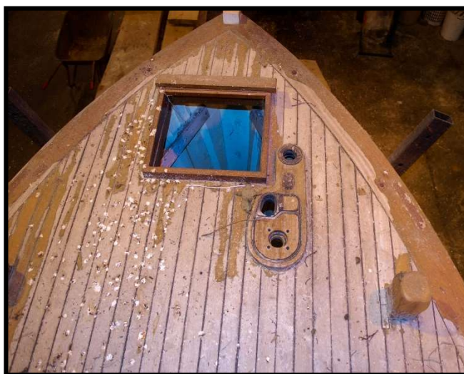
Fordekket med restene etter luke og huller etter ankervinsjen.
